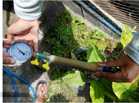
Pengukuran Tekanan Air
