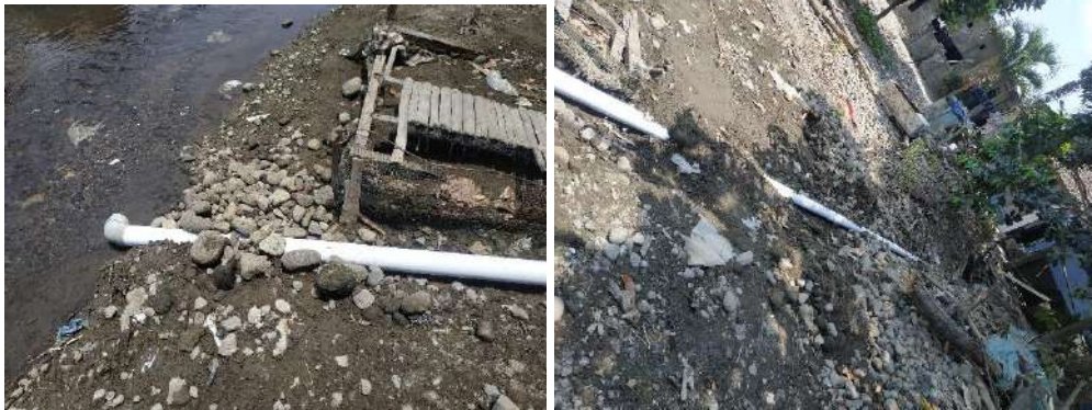
Gambar 2.4 Pipa Pembuang Rumah Tangga di Buang ke Sungai
