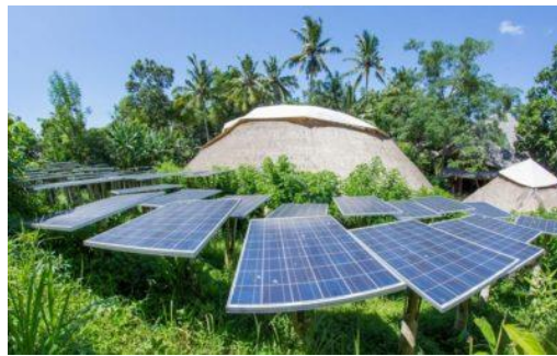
Gambar 2.38 Pemanfaatan Energi Matahari dengan Panel Surya Sumber: greenschool.org, 2020
