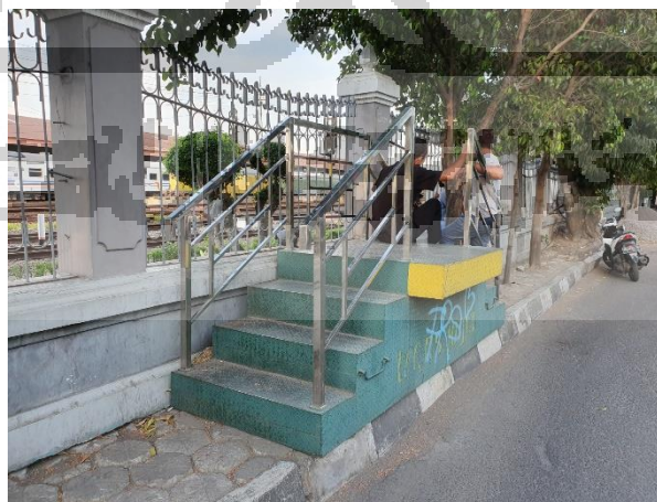
Gambar 1. 1 Kondisi Shelter di Lempuyangan yang Kurang Terjangkau
