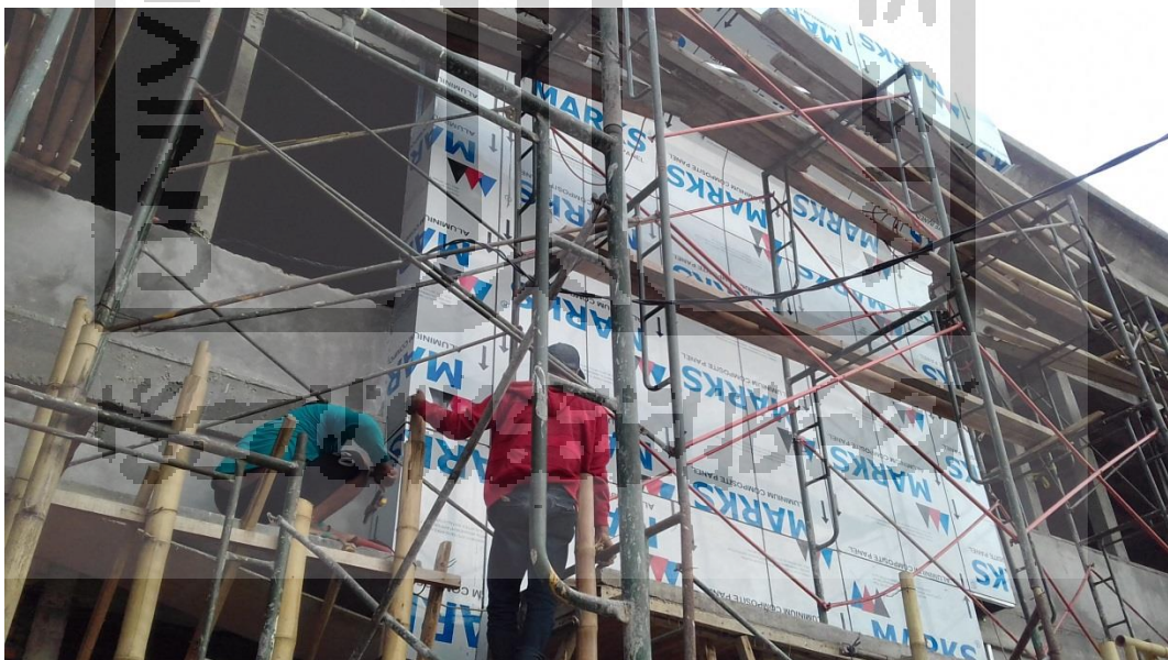
Gambar 4 : Pekerja tidak menggunakan APD
