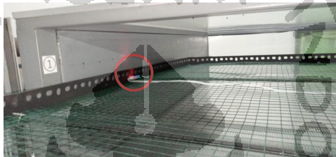
Gambar 4-5 Peletakkan sensor pada ruang pengering
