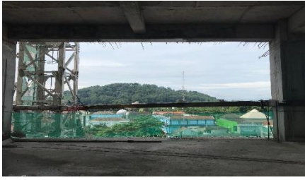
Gambar 3 Tidak adanya rambu pengaman pada tepi Gedung
