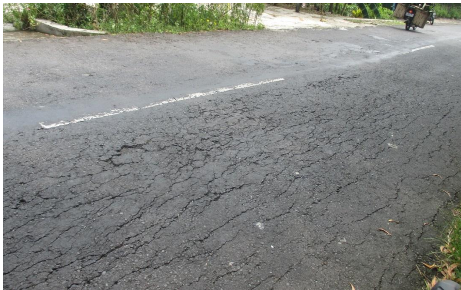
Gambar 1. 2 Kondisi Kerusakan Jalan Watusigar
