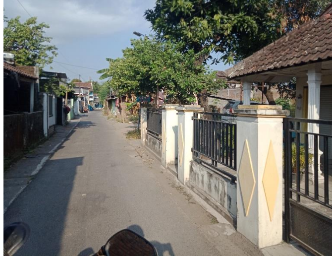
Gambar 24 : Pagar Dengan Ketinggian Kurang dari 2 Meter dan Dapat Terlihat Dari Luar Sumber : Penulis
