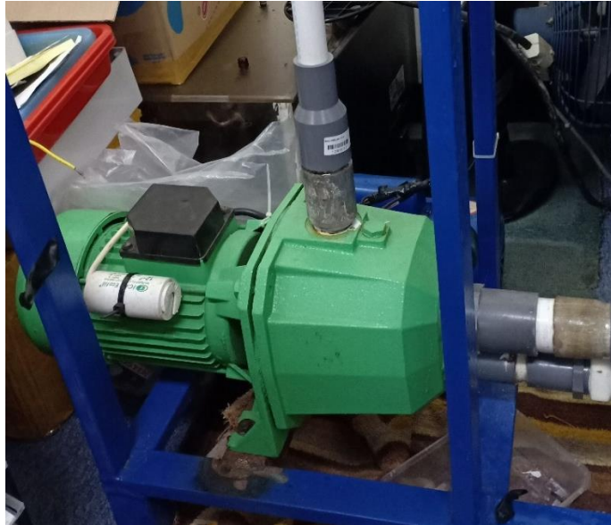
Gambar 3.3 Pompa Sirkulasi Air
