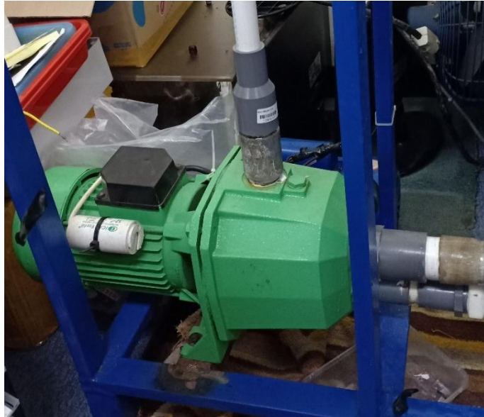
Gambar 3.3 Pompa Sirkulasi Air
