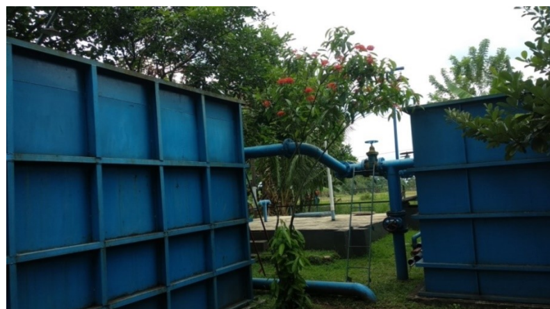
Gambar 4.11 Instalasi 1 Unit Nogotirto (atas: unit aerasi;, bawah: unit sedimentasi, unit filtrasi, reservoir)
