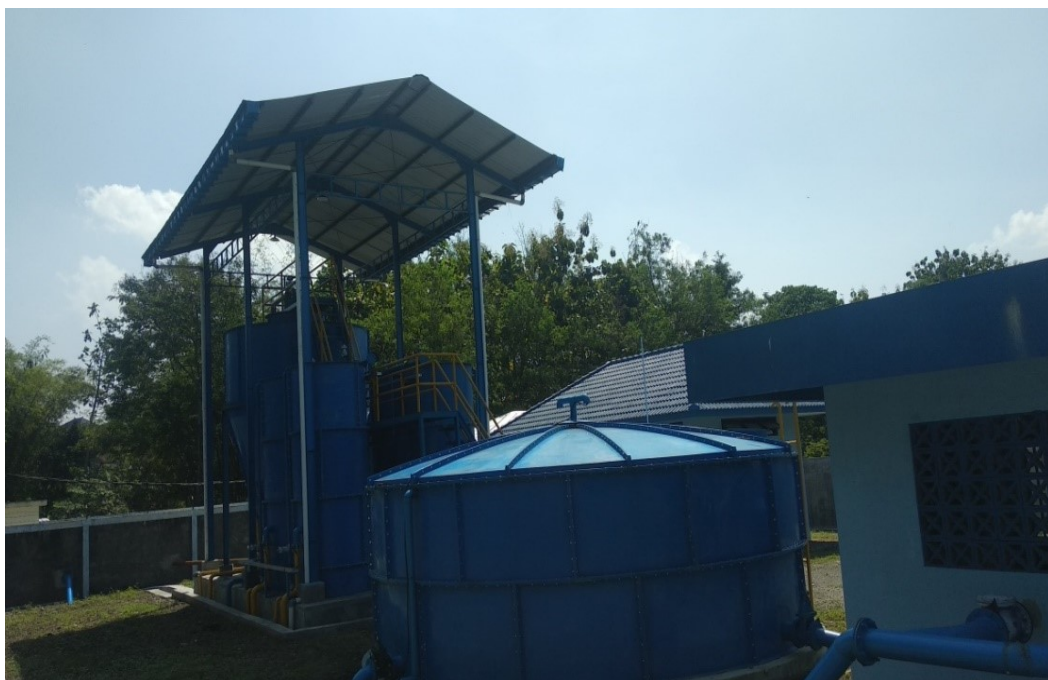
Gambar 4.13 Instalasi Bedog Unit Nogotirto
