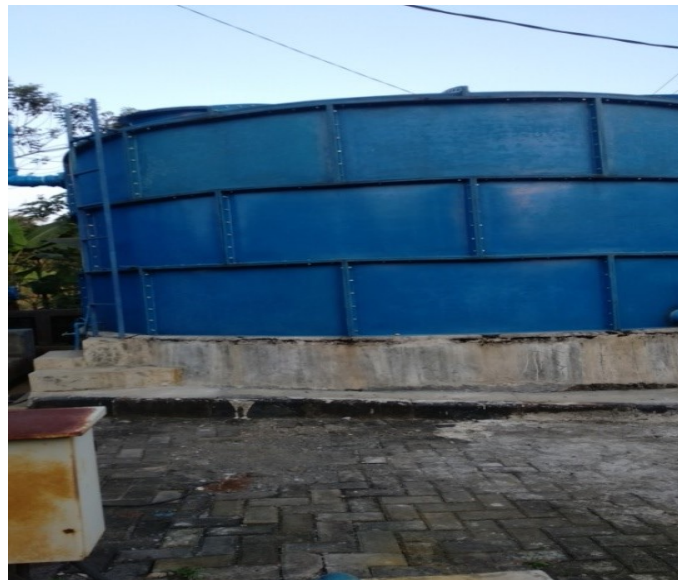
Gambar 4.5 Instalasi Godean Cabang Seyegan (atas: unit aerasi, koagulasi, dan flokulasi; tengah: unit filtrasi; bawah: reservoir)
