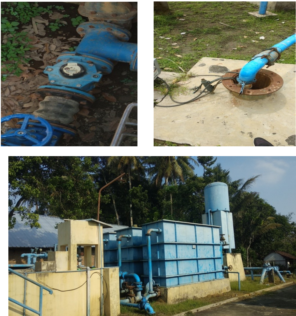
Gambar 4.31 IPA Mlati (kiri atas: meter induk, kanan atas: intake, bawah: rangkaian instalasi unit Mlati)
