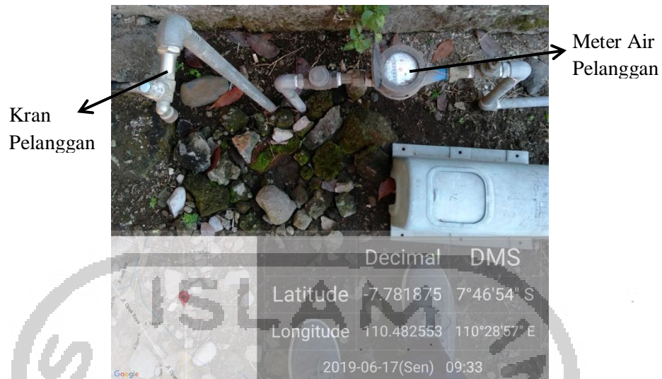
Gambar 4.23 Titik Sampling Air Unit Prambanan di salah satu kran pelanggan
