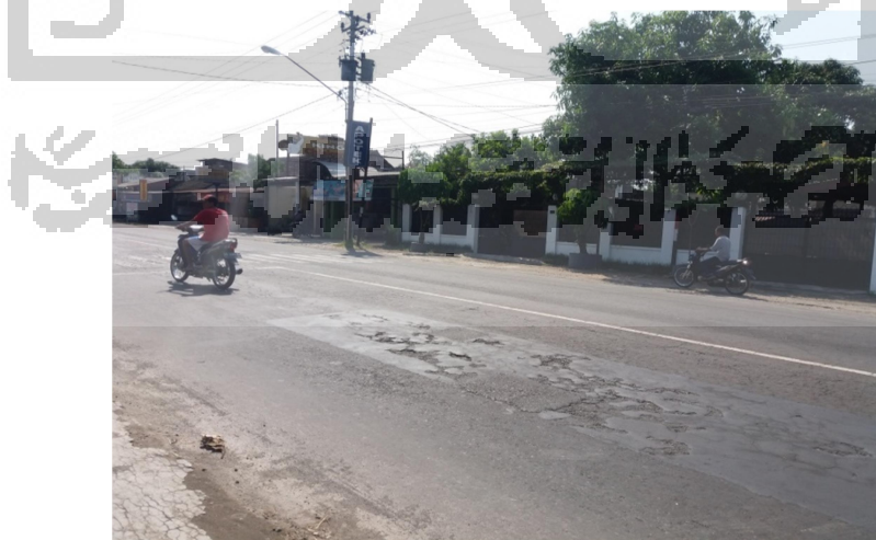
Gambar 5.32 Kondisi Permukaan Jalan Salah Satu Titik pada Ruas Jalan Yogyakarta – Bantul (Km 7 – 8)
