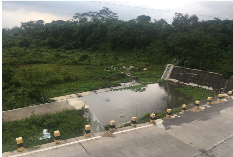
Gambar 3. 4 Jembatan Sabo Bronggang
