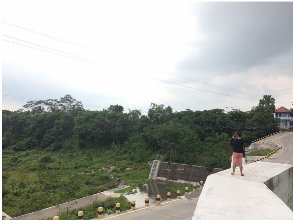
Gambar 3.5 Jembatan Sabo Bronggang
