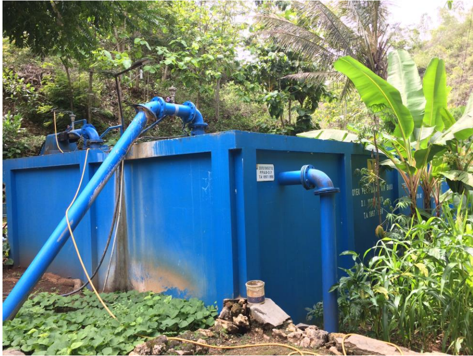
Gambar 4.28 Bak Penampung Gombang Milik SPAM Seropan (sumber : dokumentasi pribadi)
