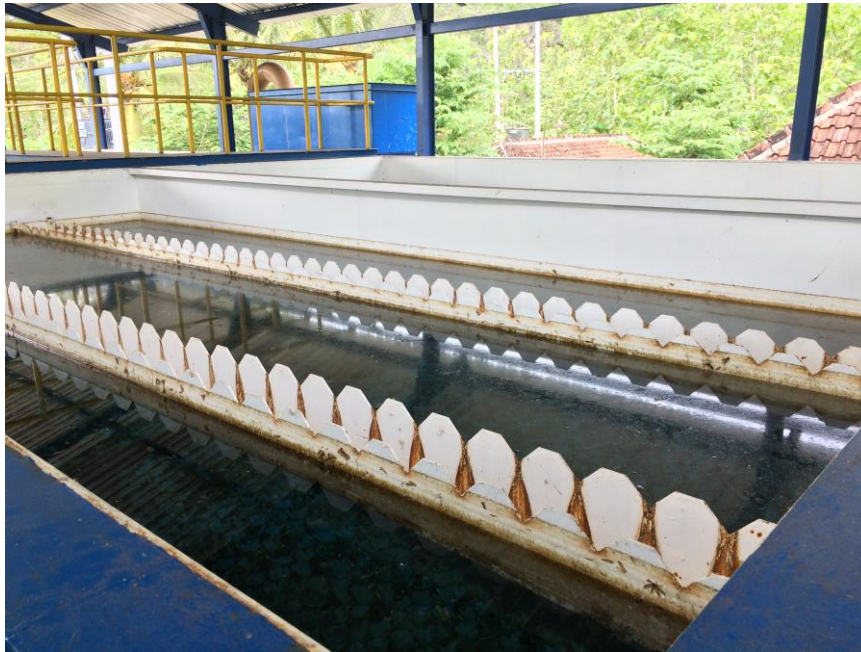
Gambar 4.20 Instalasi Pengolahan Air SPAM Bribin (sumber : dokumentasi pribadi)
