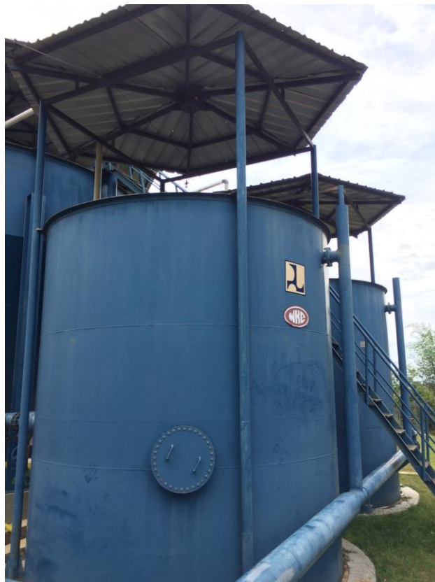
Gambar 4.22 Unit Pengolahan Sand Filter Milik SPAM Seropan (sumber : dokumentasi pribadi)
