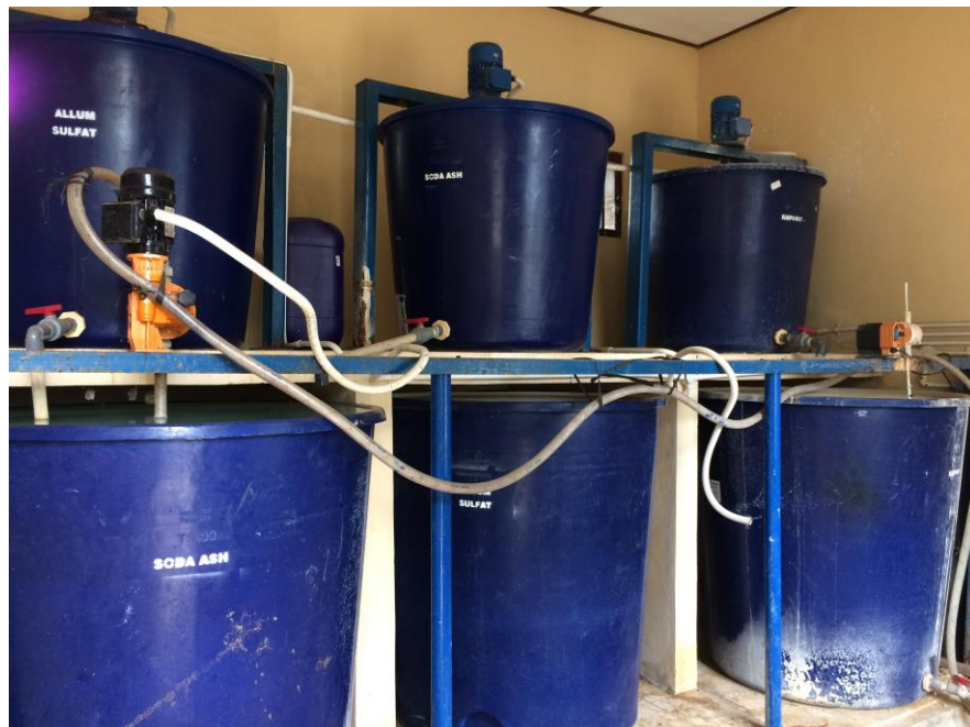
Gambar 4.24 Unit Pengolahan Desinfeksi Milik SPAM Seropan (sumber : dokumentasi pribadi)
