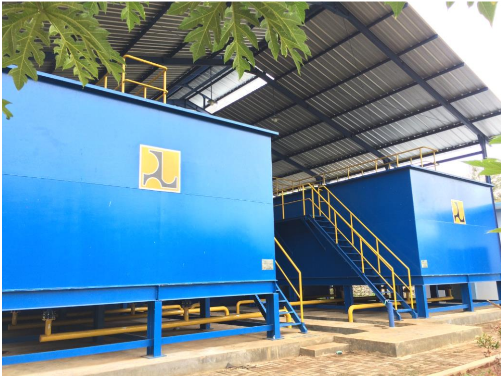
Gambar 4.8 Instalasi Pengolahan Air di SPAM Bribin (sumber : dokumentasi pribadi)
