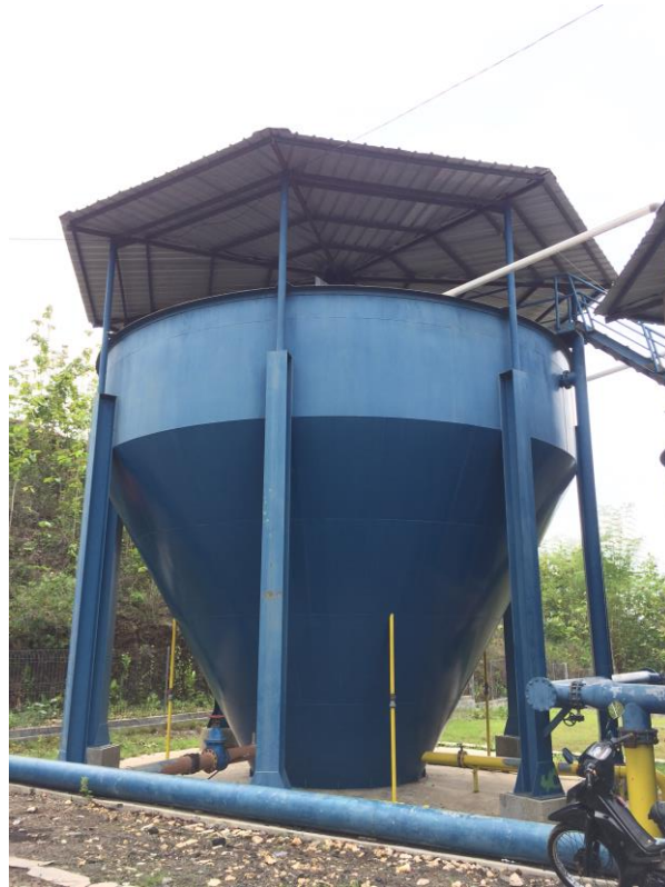
Gambar 4.23 Unit Pengolahan Clarifier Milik SPAM Seropan (sumber : dokumentasi pribadi)
