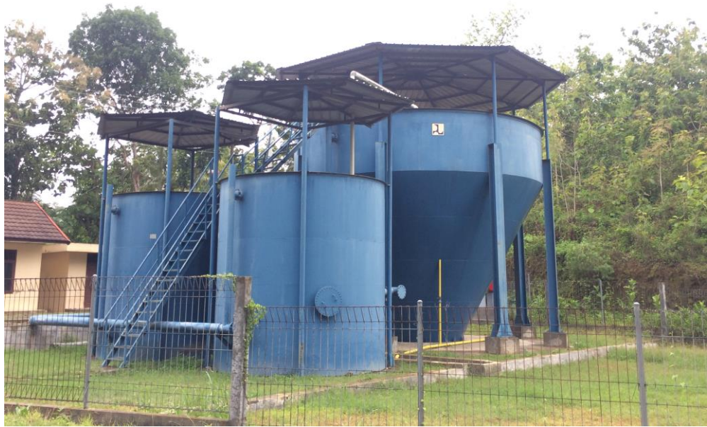
Gambar 4.11 Instalasi Pengolahan Air di SPAM Seropan (sumber : dokumentasi pribadi)
