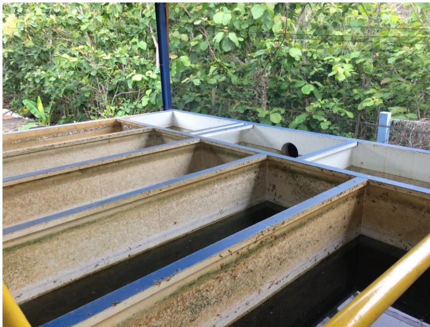
Gambar 4.19 Instalasi Pengolahan Air SPAM Bribin (sumber : dokumentasi pribadi)
