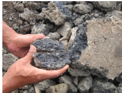
Gambar 4.38b Aspal yang Sudah Tidak Bisa Digunakan
