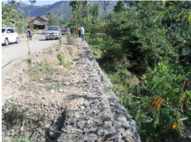
Gambar 5. 3 Foto Kondisi Lereng Setelah Terjadi Longsor
