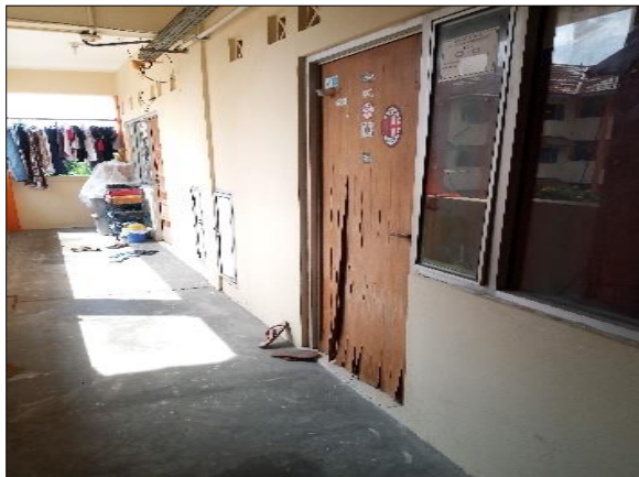
Gambar 5.11 Kerusakan Pintu di Blok C
