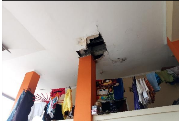
Gambar 5.9 Kerusakan Penutup Plafon di Blok C
