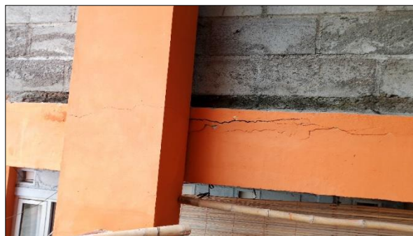
Gambar 5.2 Kerusakan Plesteran Aci Blok A
