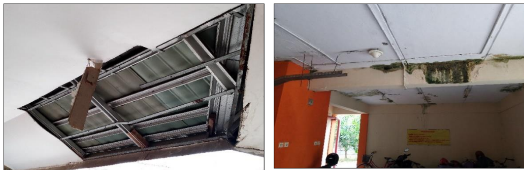
Gambar 5.15 Kerusakan Penutup Plafon di Blok D
