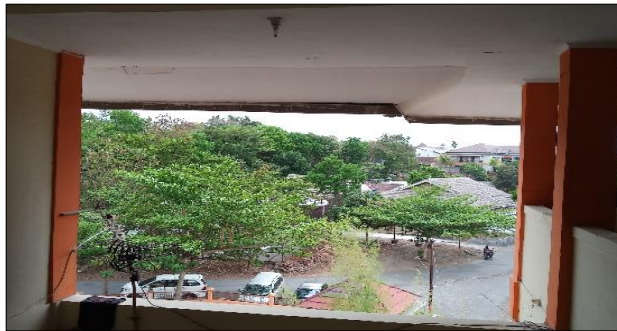
Gambar 5.13 Kerusakan Lisplang di Blok D
