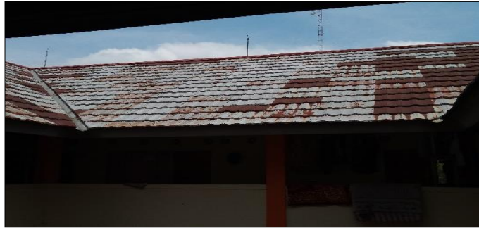
Gambar 5.12 Terkelupasnya Cat Penutup Atap di Blok D
