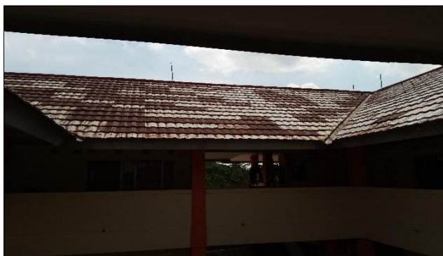
Gambar 5.6 Pengelupasan Cat Pada Penutup Atas di Blok C
