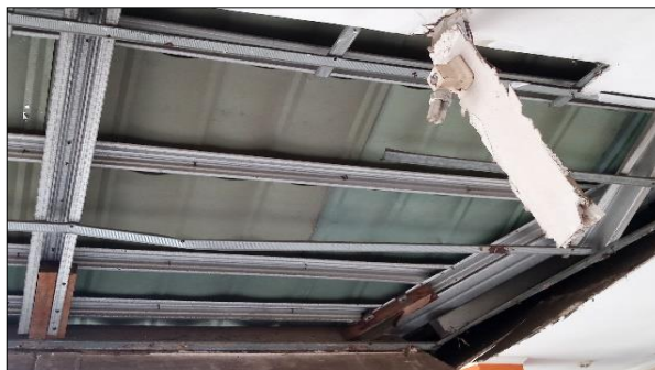
Gambar 5.14 Kerusakan Langit-Langit di Blok D
