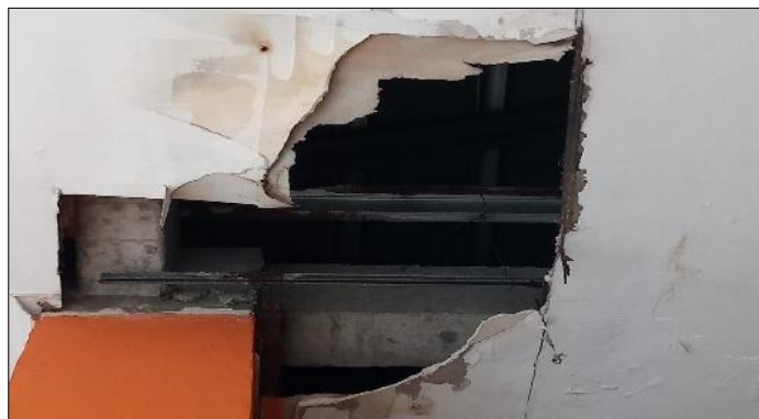
Gambar 5.8 Kerusakan Langit-Langit di Blok C
