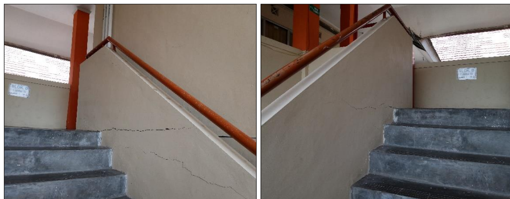
Gambar 5.16 Kerusakan Dinding 170 cm dan 130 cm di Lantai 3 Blok D
