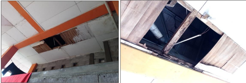
Gambar 5.4 Kerusakan Langit-Langit Blok B
