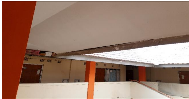
Gambar 5.7 Kerusakan Lisplang di Blok C
