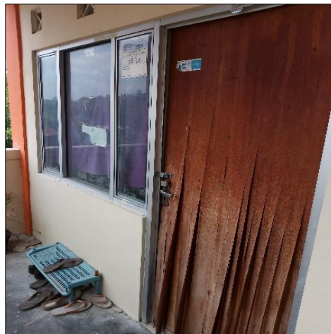
Gambar 5.19 Kerusakan Pintu di Blok D
