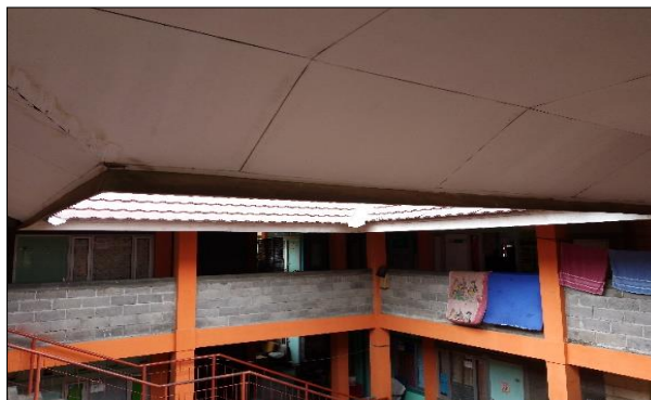
Gambar 5.3 Kerusakan Lisplang Blok B
