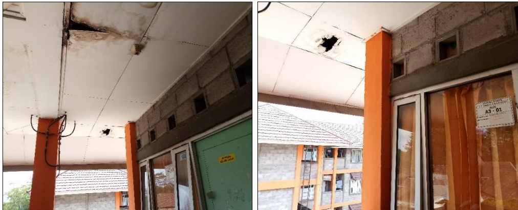
Gambar 5.1 Kerusakan Langit-Langit Blok A
