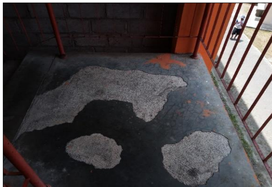
Gambar 5.5 Kerusakan Lantai di Blok B
