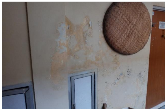
Gambar 5.10 Kerusakan Pada Cat Dinding di Blok C
