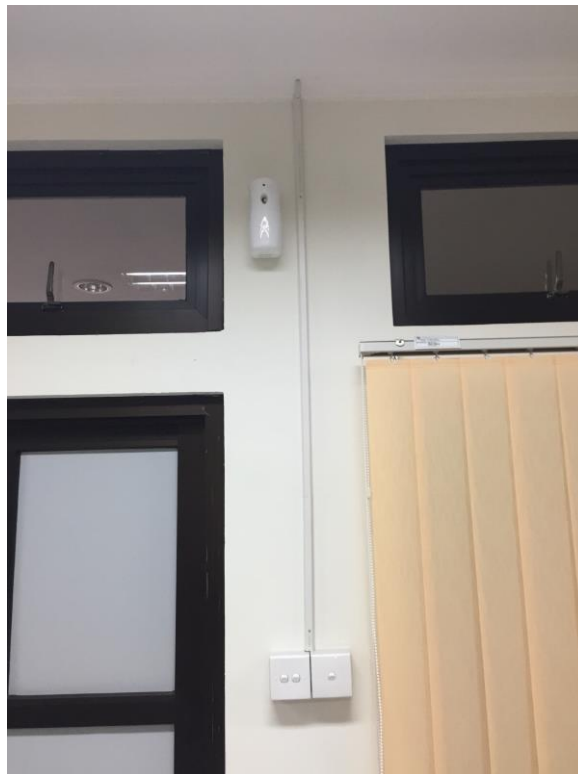
Gambar 4.15 Kabel yang Dipasang pelindung kabel
