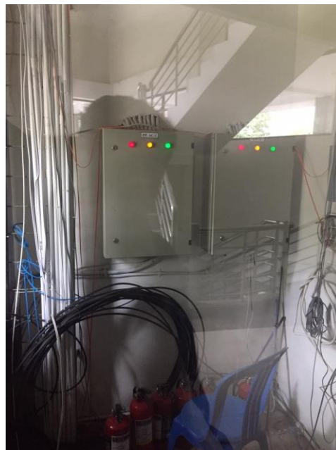
Gambar 4.19 Keadaan di dalam Ruang Panel Kontrol
