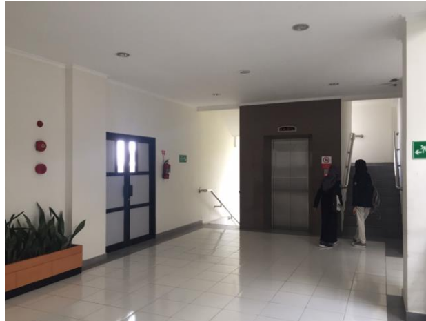
Gambar 4.16 Peletakkan APAR pada Setiap Lantai
