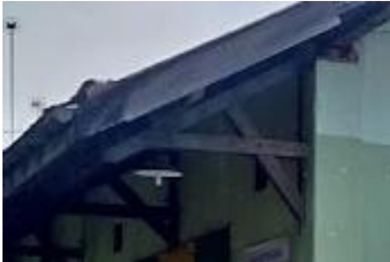
Gambar 2.39: Ornamen atap pada stasiun Medari, ornamen ini juga dimiliki oleh bangunan SMPN 1 Sleman.
