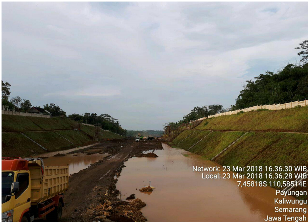
Gambar 1.2 Kondisi Riil Lereng Sta. 53+700
