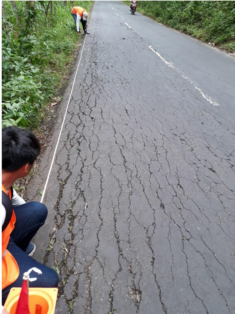
Gambar L-4.1 Survei Kerusakan Jalan Metode PCI Jalan Baron
