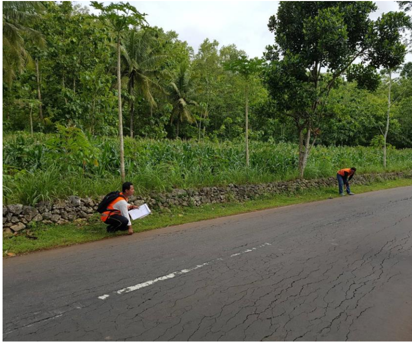
Gambar L-4.2 Survei Kerusakan Jalan Metode PCI Jalan Baron
