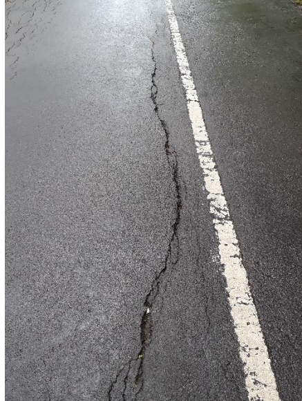
Gambar 1.1 Retak Memanjang ( Longitudinal Cracks )
