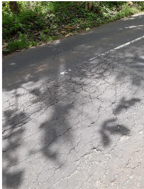
Gambar 1.2 Retak Kulit Buaya ( Alligator Cracks )
