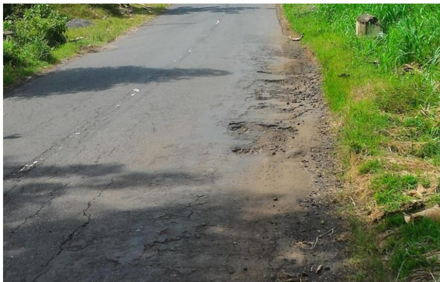
Gambar 1.4 Pinggir Pecah ( Edge Breaks )
