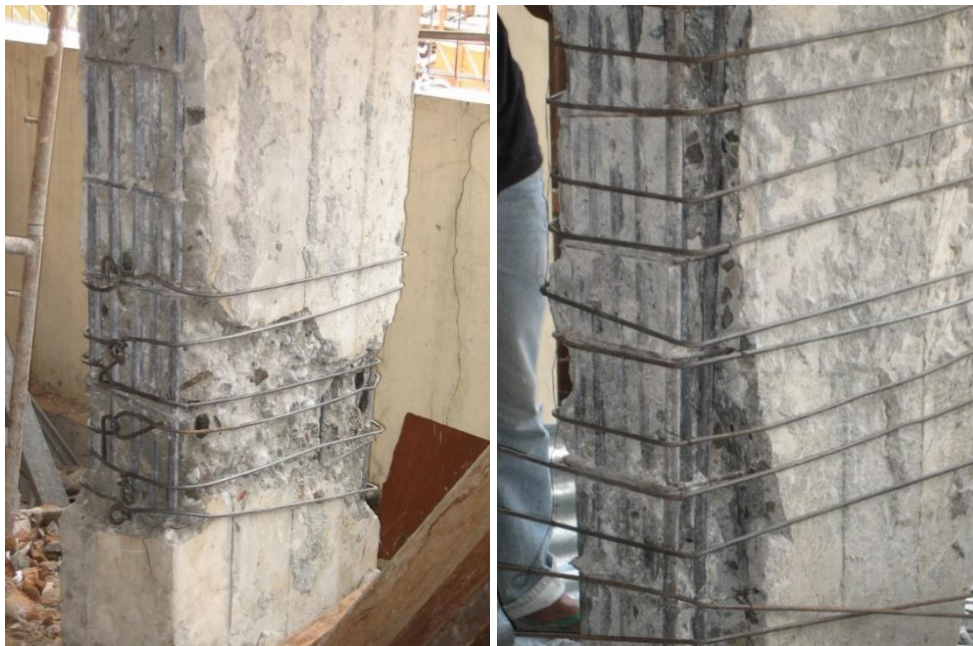
Gambar 5. 18 Tulangan yang nampak pada kolom yang mengalami kerusakan
