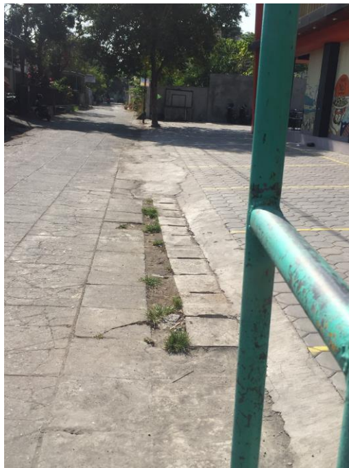
Lampiran 12. Foto Lokasi Jalan Grompol. (Sumber : kamera surveyor)
