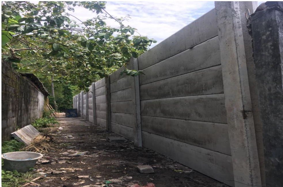
Gambar 5.1 Pemagaran Pagar Beton Precast pada Proyek Pemagaran Gudang PT. Nusa Jaya Concretama
