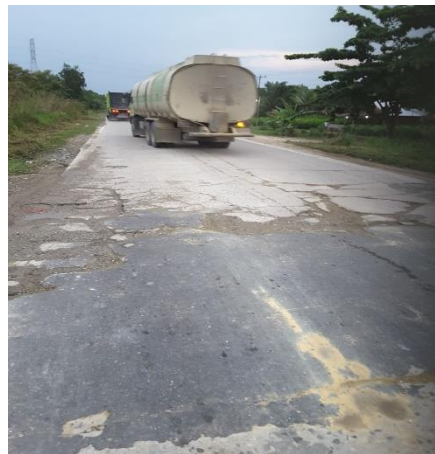
Gambar 1.1 Kerusakan pada Ruas Jalan Pekanbaru - Siak
