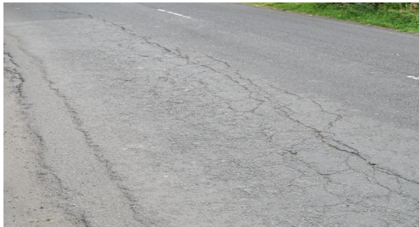
Gambar 5.22 Kondisi Permukaan Jalan Sultan Agung Segmen 6 (Arah Timur)
