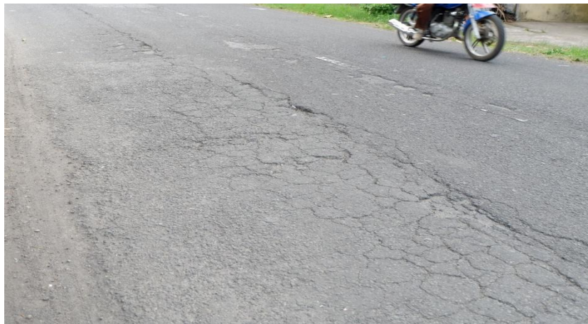
Gambar 5.20 Kondisi Permukaan Jalan Sultan Agung Segmen 5 (Arah Timur)
