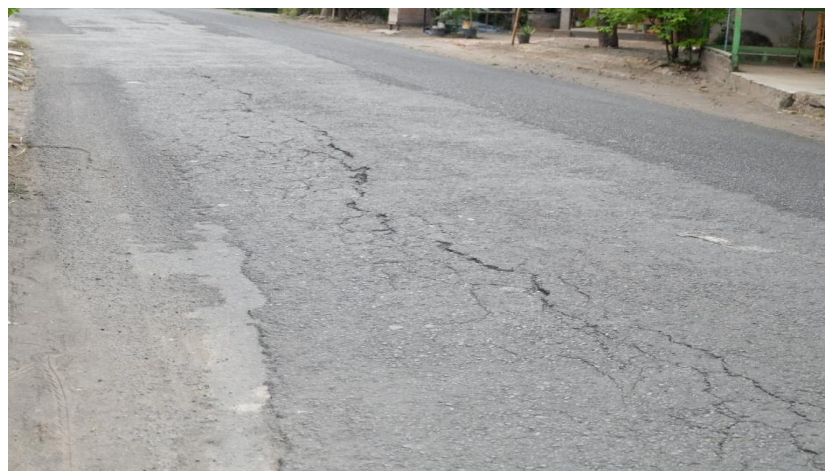
Gambar 5.16 Kondisi Permukaan Jalan Sultan Agung Segmen 3 (Arah Timur)
