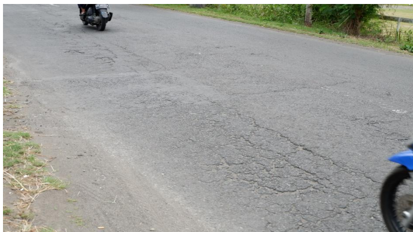
Gambar 5.36 Kondisi Permukaan Jalan Sultan Agung Segmen 13 (Arah Timur)
