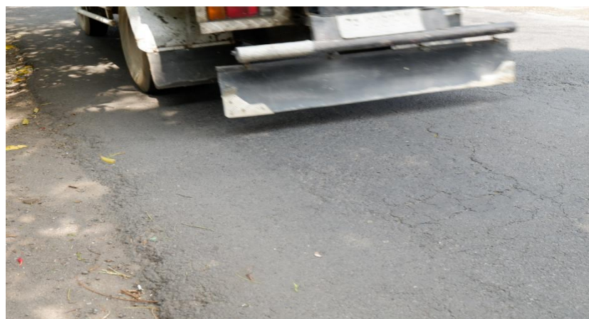
Gambar 5.38 Kondisi Permukaan Jalan Sultan Agung Segmen 14 (Arah Timur)
