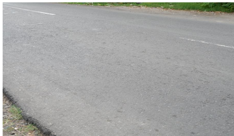
Gambar 5.12 Kondisi Permukaan Jalan Sultan Agung Segmen 1 (Arah Timur)
