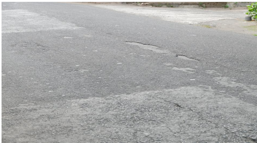
Gambar 5.18 Kondisi Permukaan Jalan Sultan Agung Segmen 4 (Arah Timur)
