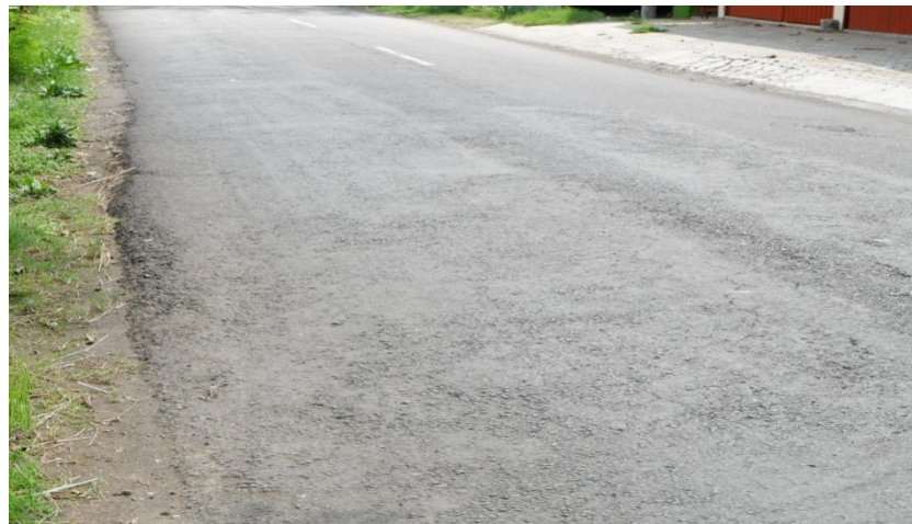
Gambar 5.26 Kondisi Permukaan Jalan Sultan Agung Segmen 8 (Arah Timur)
