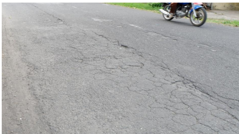
Gambar 5.32 Kondisi Permukaan Jalan Sultan Agung Segmen 11 (Arah Timur)
