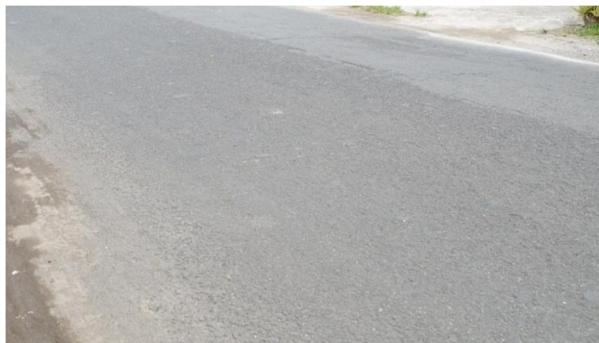
Gambar 5.30 Kondisi Permukaan Jalan Sultan Agung Segmen 10 (Arah Timur)
