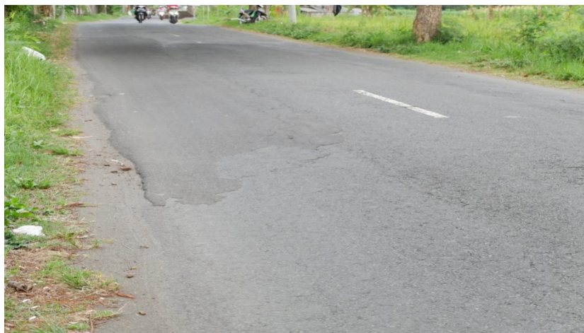
Gambar 5.24 Kondisi Permukaan Jalan Sultan Agung Segmen 7 (Arah Timur)
