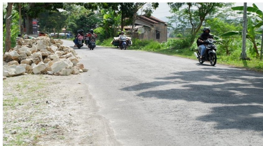
Gambar 5.40 Kondisi Permukaan Jalan Sultan Agung Segmen 15 (Arah Timur)
