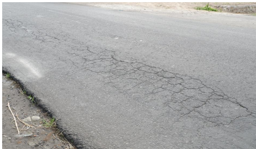
Gambar 5.14 Kondisi Permukaan Jalan Sultan Agung Segmen 2 (Arah Timur)
