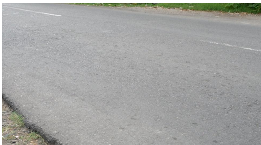
Gambar 5.28 Kondisi Permukaan Jalan Sultan Agung Segmen 9 (Arah Timur)
