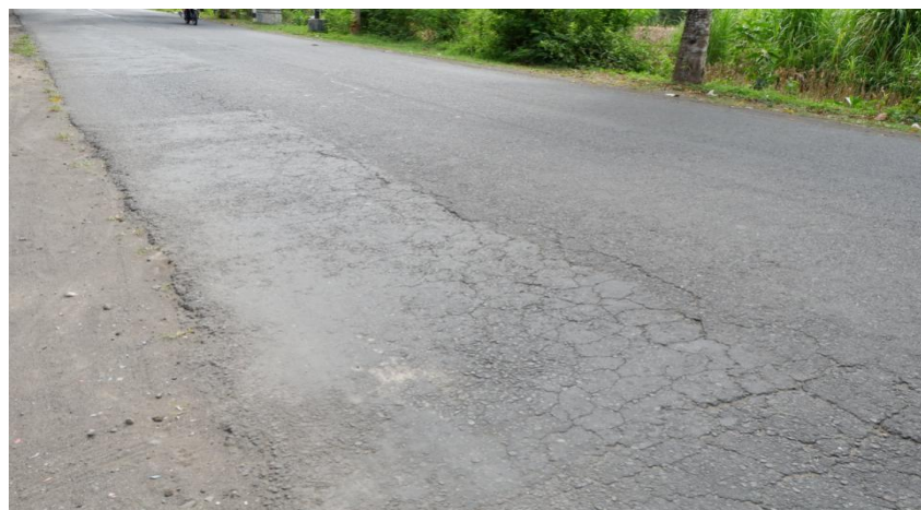
Gambar 5.34 Kondisi Permukaan Jalan Sultan Agung Segmen 12 (Arah Timur)
