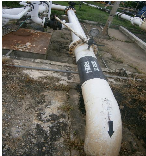
Gambar 5.2 Bagian Pipa Penyalur di Area Proses Pemurnian
