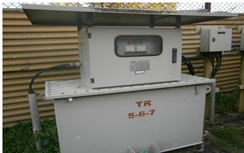
Gambar 5.5 Transformer Rectifier Untuk Proteksi Katodik Pipa Penyalur
