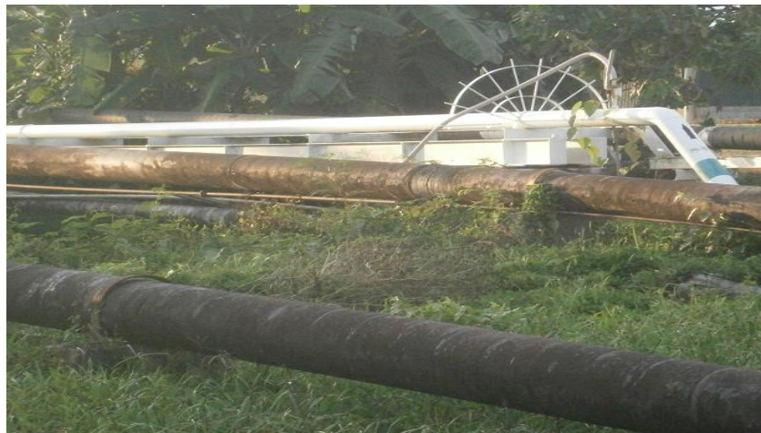
Gambar 5.4 Kondisi Pipa Penyalur di Tanah Terbuka
