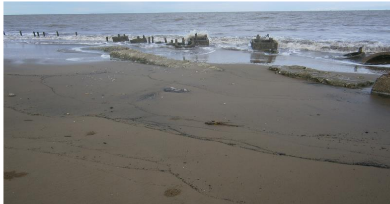
Gambar 5.7 Kondisi Pipa Penyalur Tertanam di Garis Pantai
