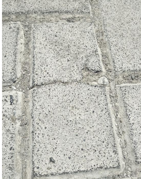
Gambar L-6.1 Pola Kerusakan Paving Block Lokasi Perumahan Tiara Mas Blok O, Banguntapan Bantul
