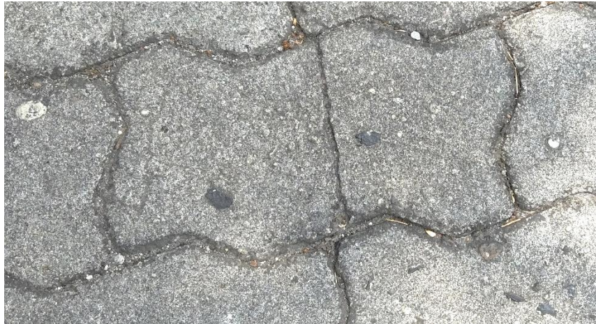
Gambar L-6.3 Pola Kerusakan Paving Block Lokasi Perumahan GPW Jl. Kaliurang Km. 13,5 Sleman
