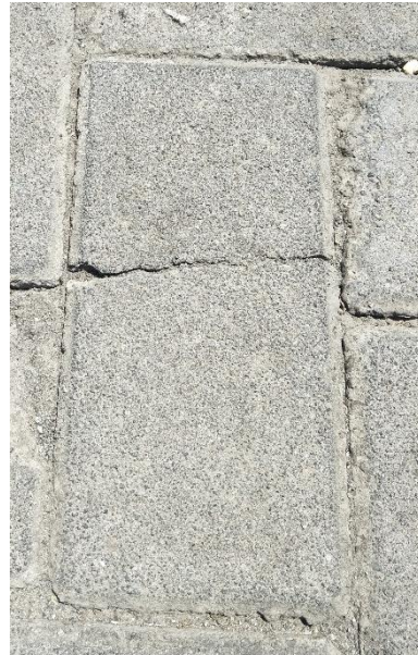
Gambar L-6.2 Pola Kerusakan Paving Block Lokasi Indomari Agency, Banguntapan Bantul
