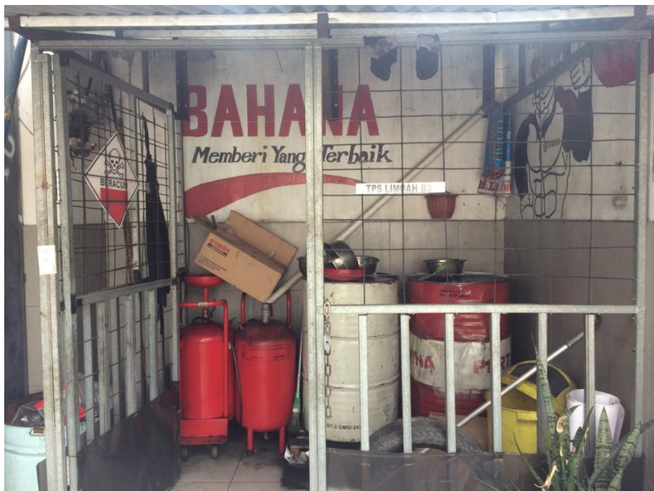
Gambar Lampiran 4 – Fasilitas Pemadam Kebakaran Bangunan Penyimpanan Limbah Pelumas Bekas
