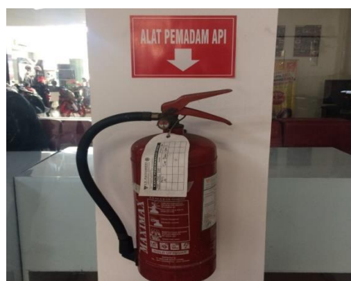
Gambar 4.11 Fasilitas pemadam kebakaran dibangunan bengkel perusahaan X
