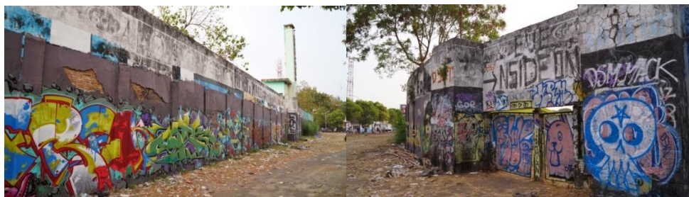
Gambar 1. 3. Tampak Vandalisme pada dinding luar stadion kridosono 2
