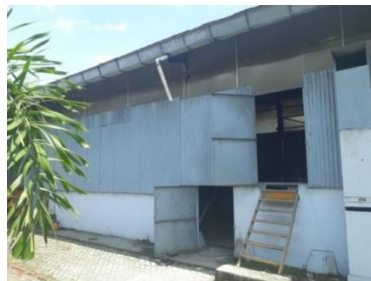
Gambar 5.8 Pipa Air hujan rusak
