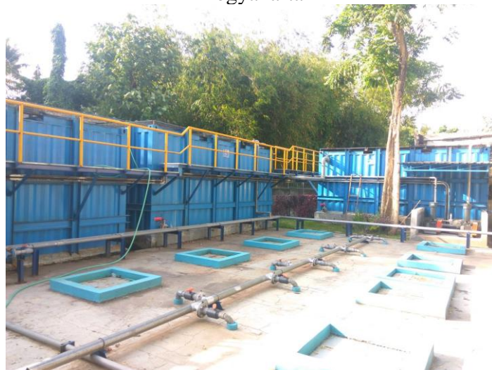
Gambar 4.15 Bak aerasi (kiri), bak sedimentasi (ujung atas) dan bak ekualisasi (tengah) di unit IPAL Rumah Sakit “JIH” Yogyakarta
