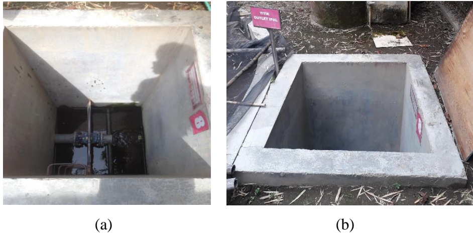
Gambar 4.19 (a) dan (b) Effluent tank di unit IPAL Rumah Sakit “JIH” Yogyakarta
