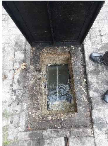
Gambar 4.3 Grease trap pada dapur umum Rumah Sakit “JIH” Yogyakarta
