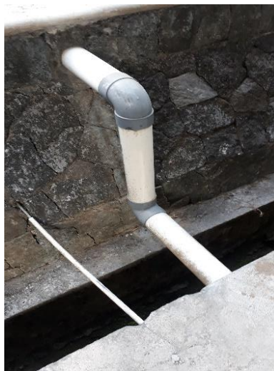
Gambar 4.9 Pipa pembawa air limbah dari bak penampungan menuju IPAL
