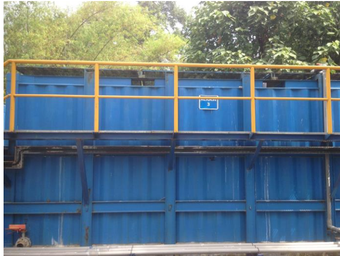
Gambar 4.13 Bak aerasi di unit IPAL Rumah Sakit “JIH” Yogyakarta
