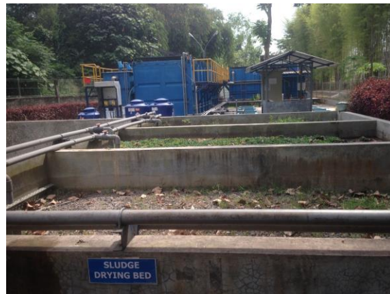
Gambar 4.21 Sludge Drying Bed (Tampak Keseluruhan) di unit IPAL Rumah Sakit “JIH” Yogyakarta
