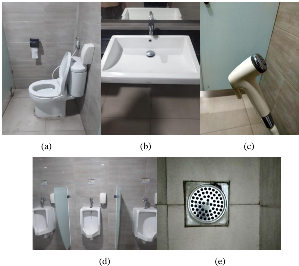
Gambar 4.2 Alat Saniter pada publik toilet (a) Kloset (b) Wastafel (c) Jet Shower (d) Urinoir/peturasan (e) Floordrain
