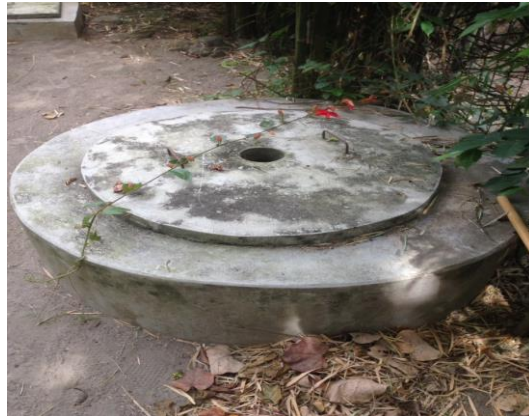
Gambar 4.11 Pit Collector pada unit IPAL Rumah Sakit “JIH”
