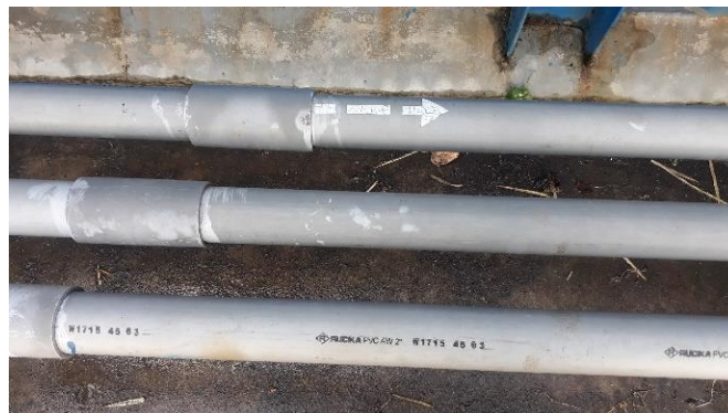
Gambar 4.7 Tanda pada perpipaan di unit IPAL Rumah Sakit “JIH” Yogyakarta
