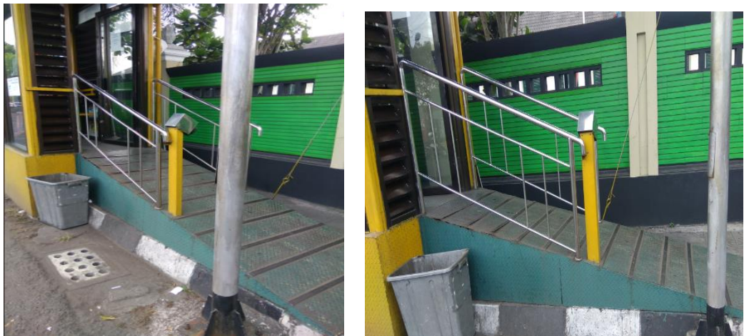
Gambar 3.10. Kondisi Ramp di halte SMP 5 Yogyakarta yang masih curam
