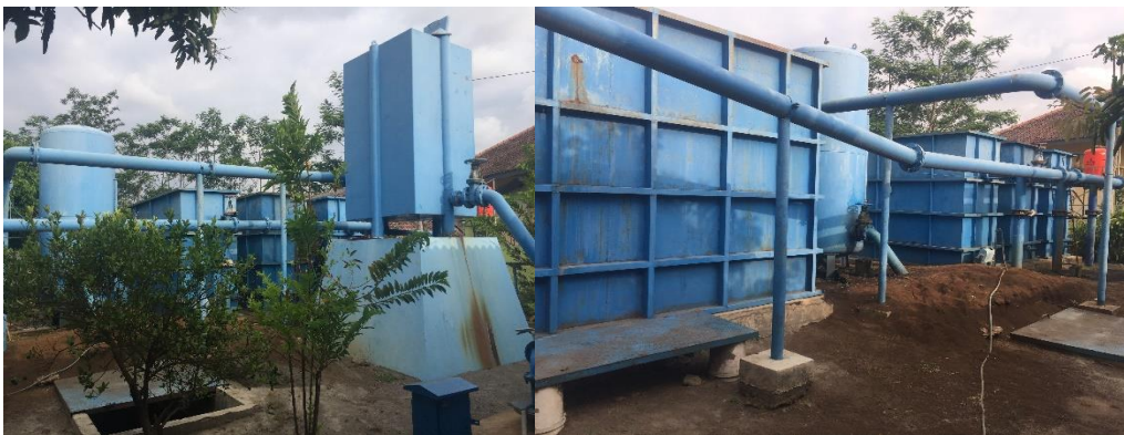
Instalasi Bangunharjo PDAM Bantul Unit Sewon
