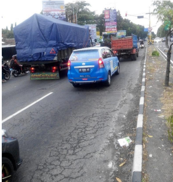
Gambar 1.3 Permukaan Jalan Mengalami Retak ( Cracking )
