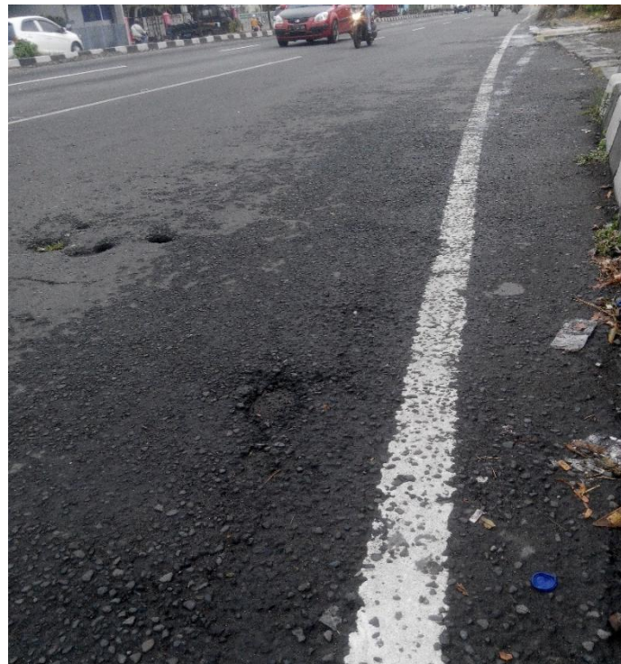
Gambar 1.4 Kerusakan Permukaan Berupa Lubang ( Pothole )
