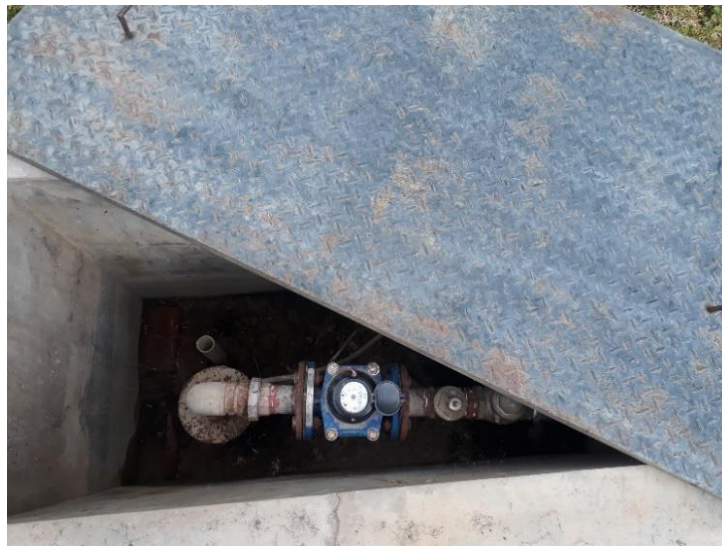
Gambar 4.4 Meter Air Sumur Dalam
