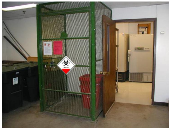
Gambar 4.11 Fasilitas Penyimpanan Limbah B3 yang Berada di Dalam Bangunan Utama.
