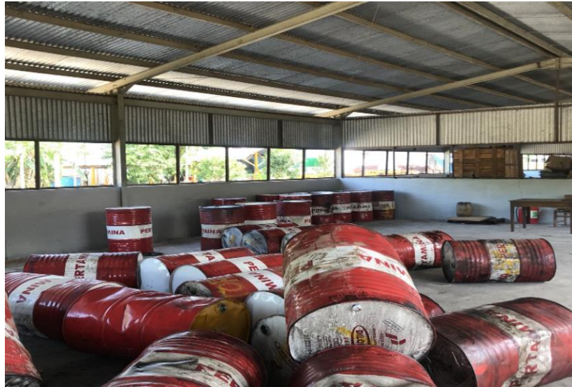
Gambar 4.11 Kondisi Ventilasi TPS Balai Yasa
