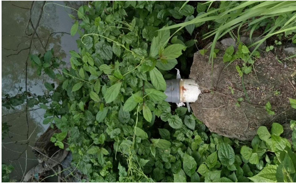
Gambar 4.12 Outlet IPAL Komunal Dusun Gancangan
