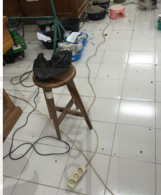
Kondisi Kabel Yang Berpotensi Bahaya ( di Area Lab Jalan Raya)
