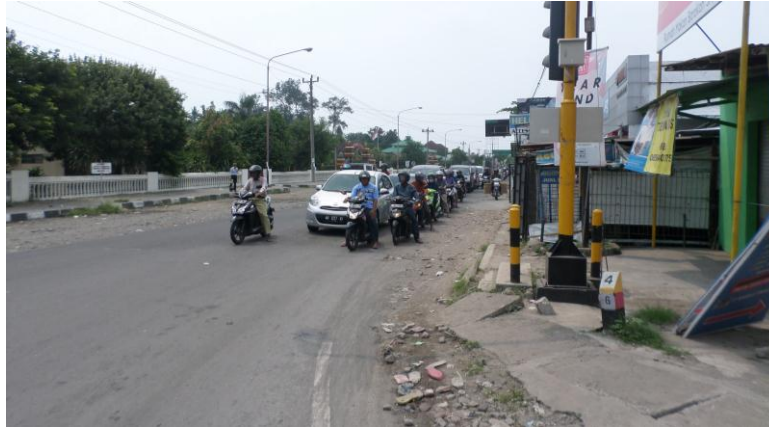
Gambar 5.2. Kondisi Permukaan Jalan STA 0+000 (Sumber: Data Primer)
