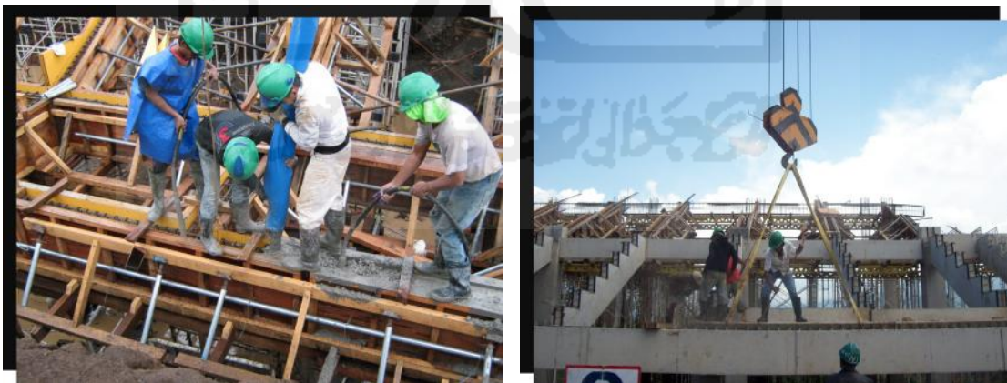
Gambar 5.1 Penyelesaian Tribun Timur Stadion Madya Moch Soebroto Sumber : Dokumentasi Proyek Pembangunan Stadion Madya ( Tahap 8)
