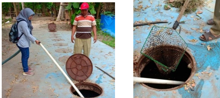
Gambar 4.7 Penyedotan dan Proses Pembersihan Sampah secara Manual pada IPAL komunal.
