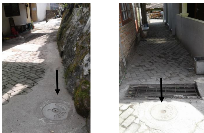
Gambar 4.31 Pembuangan Air Limbah ke Pipa IPAL Sanimas
