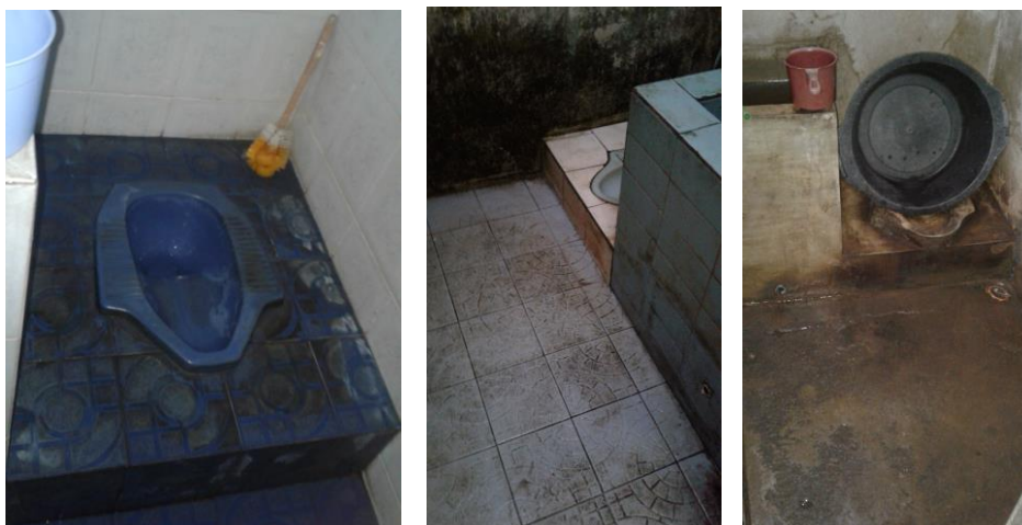
Gambar 4.37 Kondisi Lantai MCK yang Kotor
