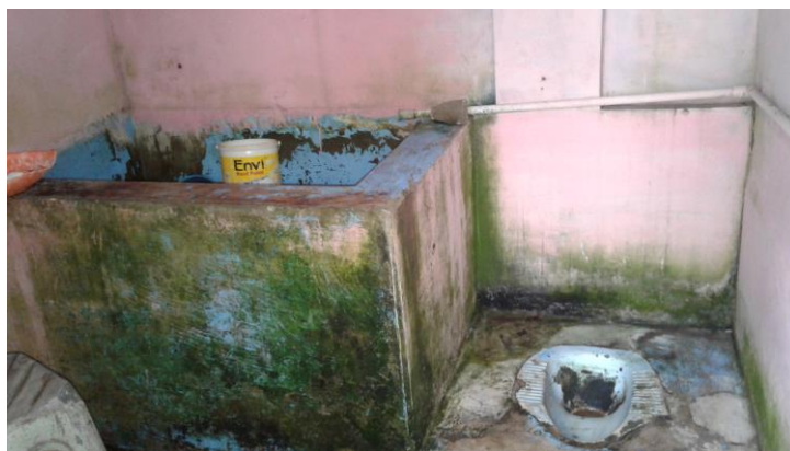
Gambar 4.36 Kondisi Fasilitas MCK yang Kotor dan Memiliki Bagian yang Rusak
