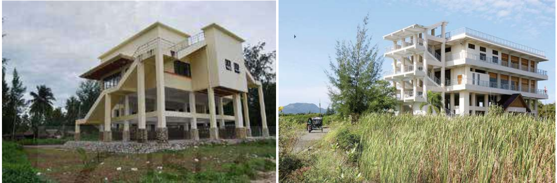
Gambar 2-6 dan 2-7. Shelter Tsunami yang Tidak Terawat
